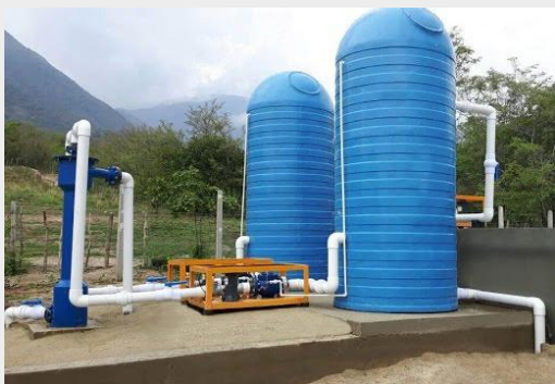
Sistemas de planta potabilizadora portátil y pileta pública
